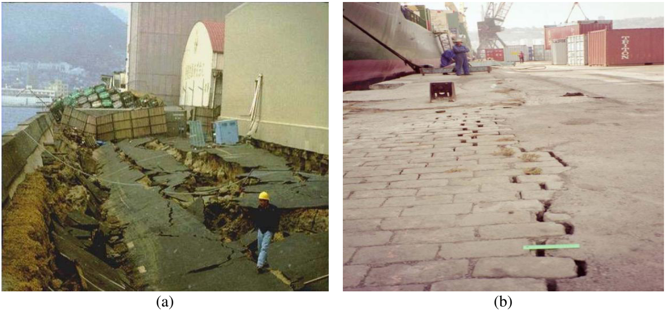
Figure 1.3- Déplacement latéral de quais :(a) séisme Kobe 1964, (b) séisme Boumerdes 2003 [16].
