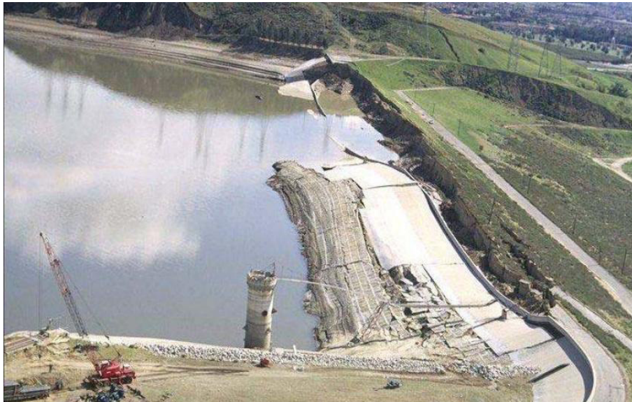
Figure 1. 4- Effondrement du parement amont d'un barrage, séisme de San Fernando 1971 [2].
