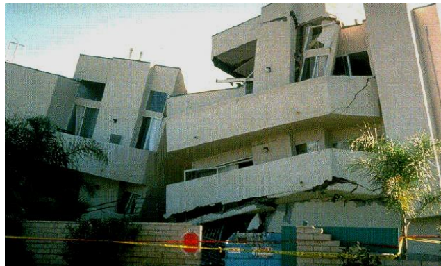
Figure 1.28 : effondrement des porte-a-faux, séisme Los Angeles (1994)
