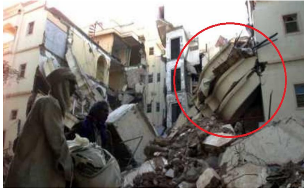
Figure 1.29: Effondrement des balcons en porte-à-faux, séisme Gujarat, en Inde (2001)
