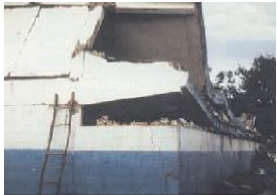
Figure 1.34: effondrement des poutres consoles en séisme de Cariaco en Venezuela (1997)
