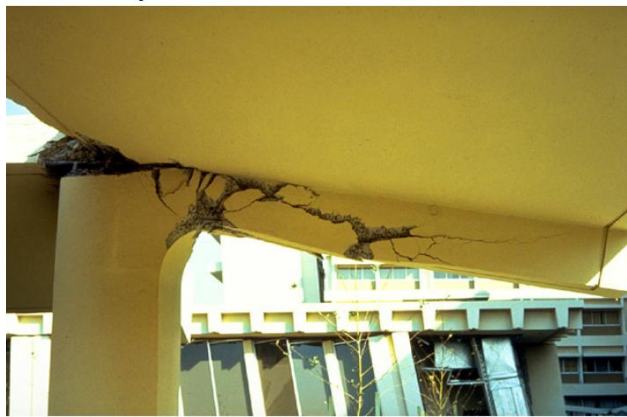
Figure 1.30 : Rupture de porte-à-faux, séisme de San Fernando, aux États-Unis (1971)
