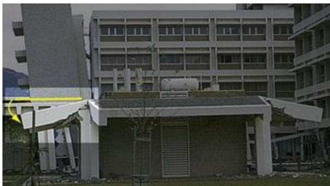
Figure 1.31 : Une rotation de la poutre console, séisme de San Fernando, en Californie (1971)
