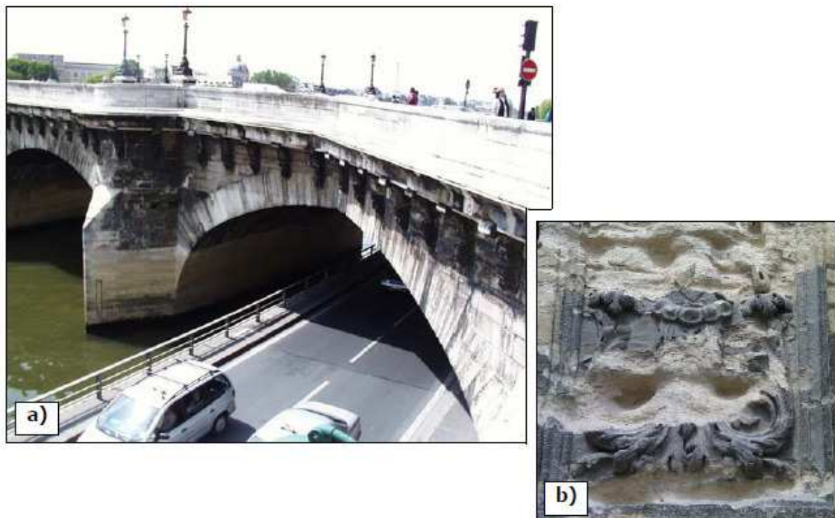
Figure 2.5 : Effets de la pollution sur le bâti, présence de croûtes noires [42]
