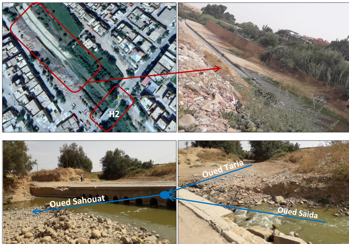
Photos III.1 : Ecoulement des eaux usées en période estivale au niveau de l'oued Saïda.
