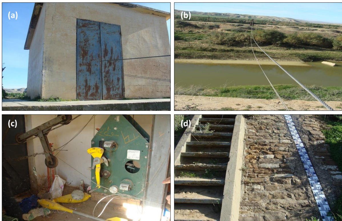
Photos I.15 : Station hydrométrique d'oued El-Abtal, B.V. de l'oued Mina Photos, TOUBAL A. K. (26/12/2018) (a) Station contenant les appareillages de mesure (b) Câble téléphérique (c) Appareillages de mesure et moteur téléphérique (d) Echelle limnimétrique pour la mesure des hauteurs d'eau.
