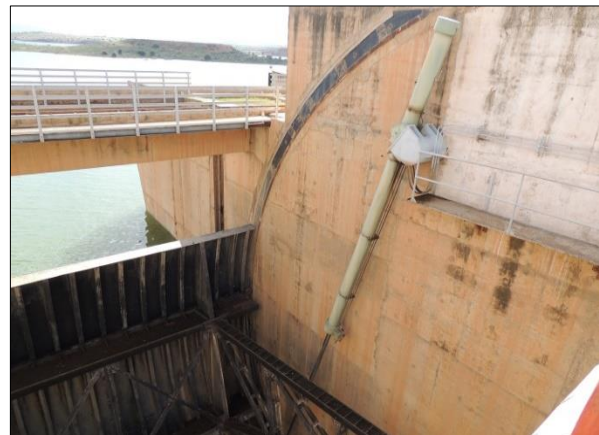
f) Vanne de l'évacuateur de crues.
