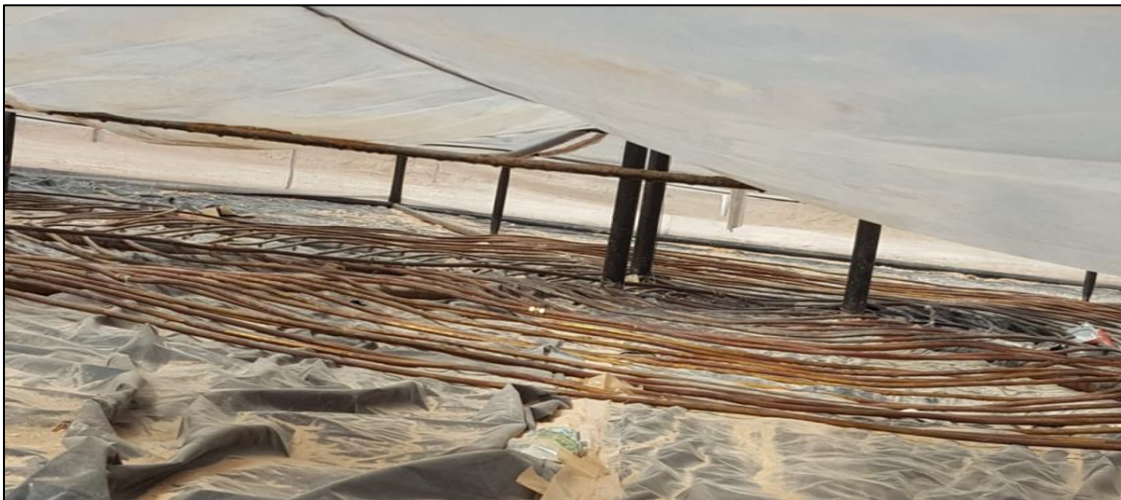
Fig. III.23 : Serpentin en cuivre installée à l'intérieur du collecteur de la CCS
