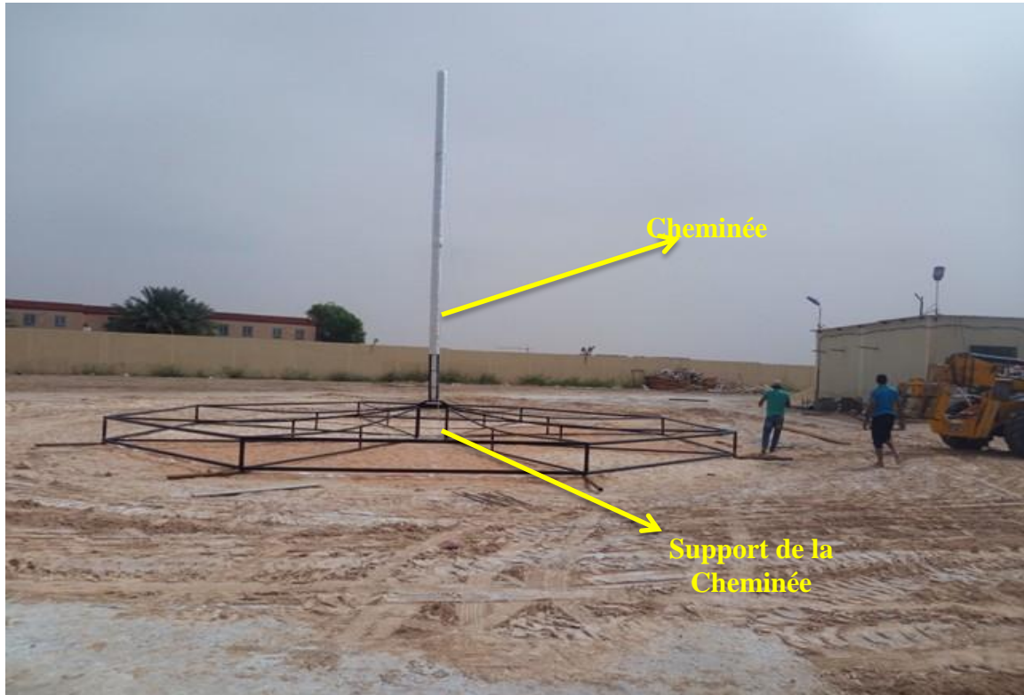
Fig. III.19 : La cheminée installée dans le prototype n°3
