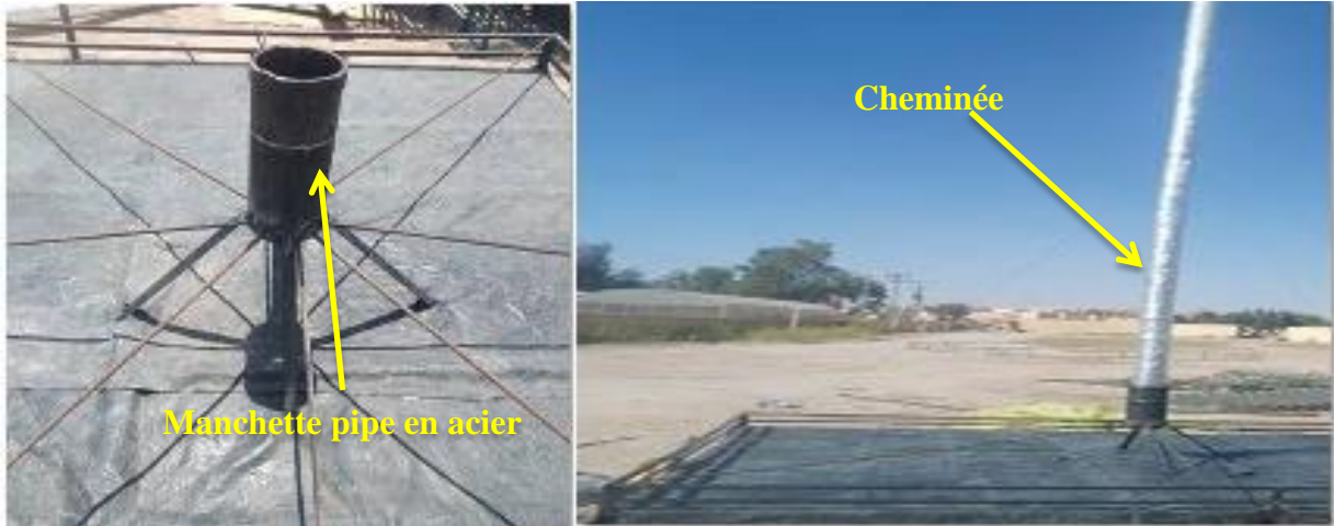
Fig. III.4 : La cheminée utilisée avec un support en acier
