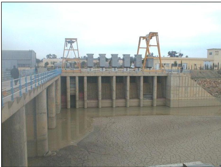
Figure 4 -21: Ensablement de la station de pompage de Boulefred sur l'Oued Sly.
