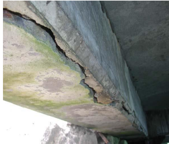
(c) Fissure longitudinale au niveau de la poutre.
