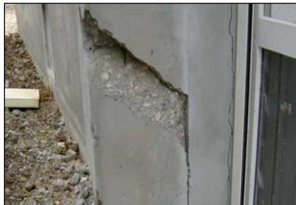
Figure 1.7 – Ouvrage en béton altéré sous l'effet des chocs (Parexlanko 2008).
