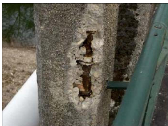
Figure 1.2 – Élément en béton carbonaté (Parexlanko 2008).
