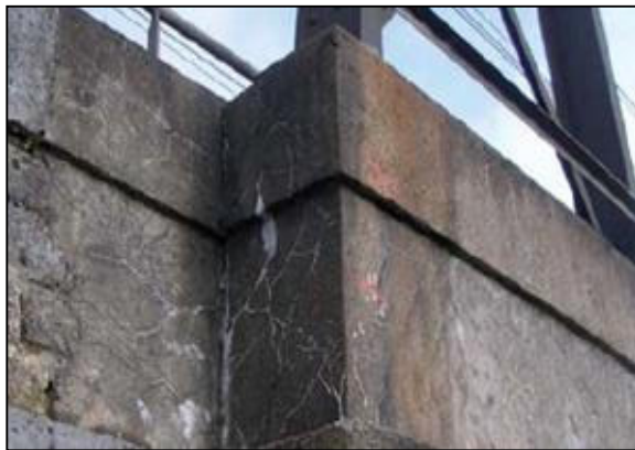
Figure 1.4 – Effet de l'alcali-réaction sur une structure en béton armé (Parexlanko 2008).
