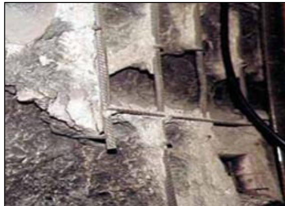
Figure 1.8 – Structure en béton armé dégradée par le feu (Divet et al. 2005).
