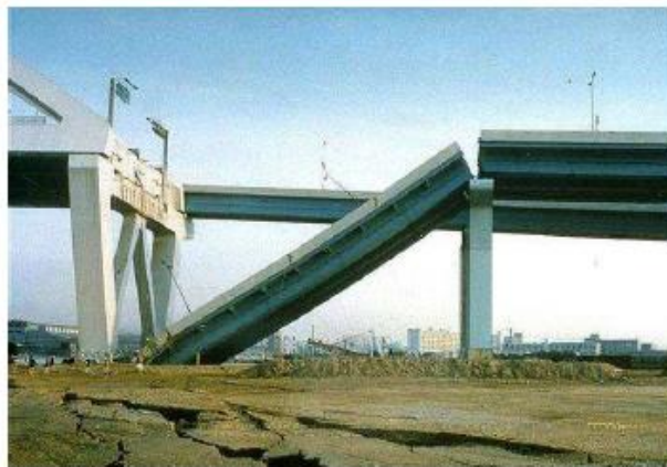
(a) Echappement du tablier (Kobe, 1995)
