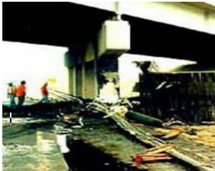
Figure 1.7. Choc sur une pile de pont.
