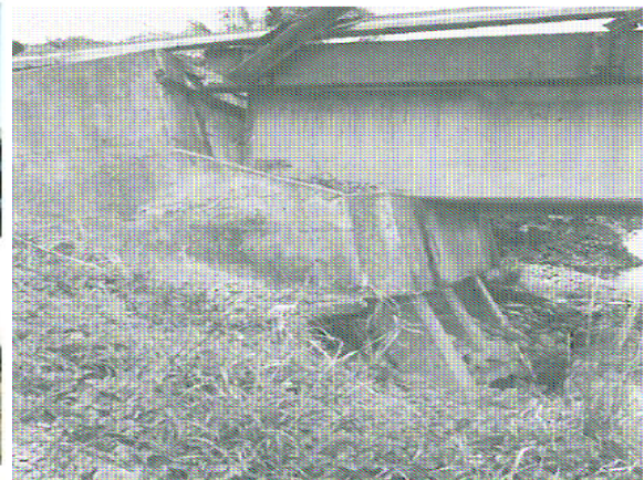
(b) Rupture par affaissement et rotation de la culée
