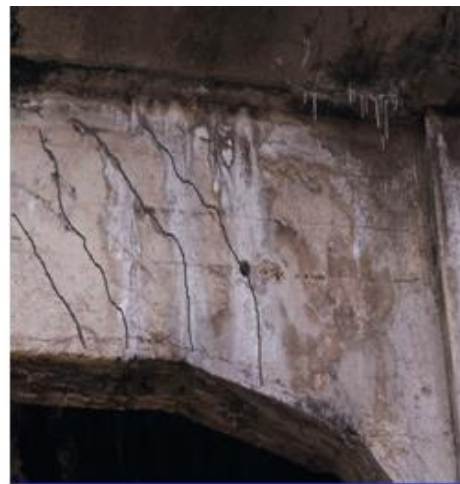
(b) Fissures d'effort tranchant
