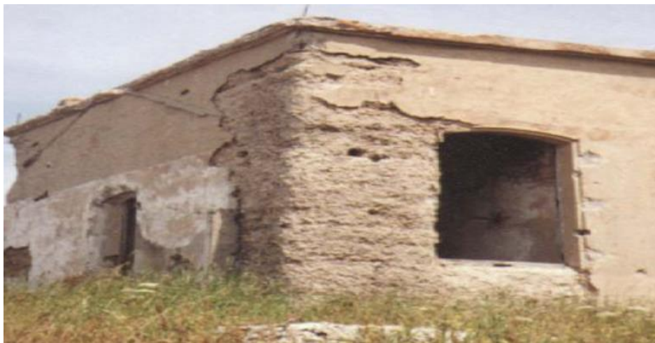
Figure 1.6. Dégradation d'un ouvrage soumis au gel dégel [25].
