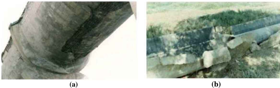
Photo n°1 : L'état de réseau d'irrigation dans le périmètre du Bas Chélif : (a) canal principal, (b) canal secondaire (Mouhouche et Gumraoui, 2004).
