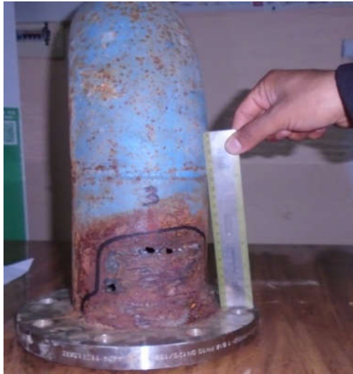
Figure VI. 1. Apparition des défauts à l'externe à la surface du coude 90°.
