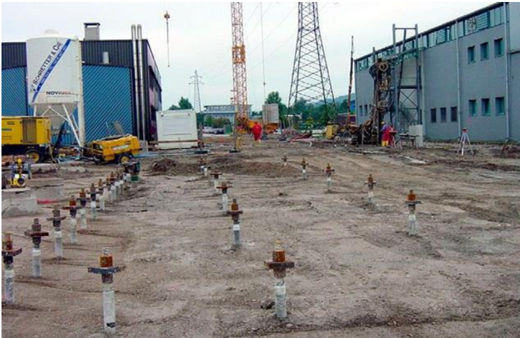
Fig. 1.40 — Micropieux, Construction d'un centre logistique de 4.000 m 2 dans le Tirol en Autriche - Détail - 2003
