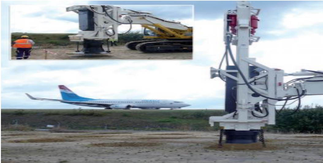
Fig. 1.23 — Extension de la plateforme Höhenhof de l'aéroport du Findel (Luxembourg) en 2009 Surface traitée 6.635 m 2
