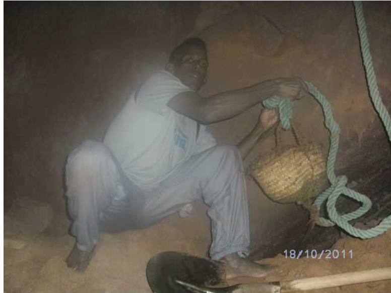
Figure.3.5. Difficultés de travail d'entretien à l'intérieur de galerie (Photo Salah Hebi, 2011)
