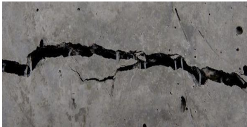
Figure 1. 3 : Image de pontage des fissures par des fibres de polypropylène (Faula, 2020).
