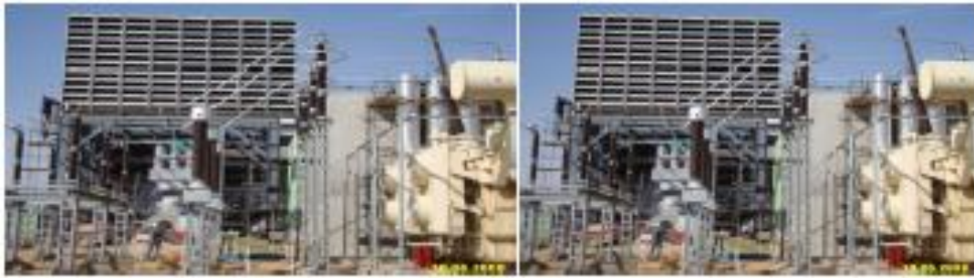
Centrale électrique M'sila – SONELGAZ
