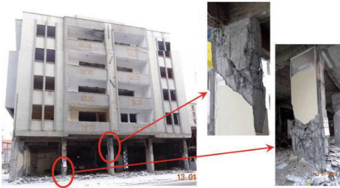
Figure I.2 : Dommages structurels dus aux effets des étages souples (Van, Turkey 2011).
