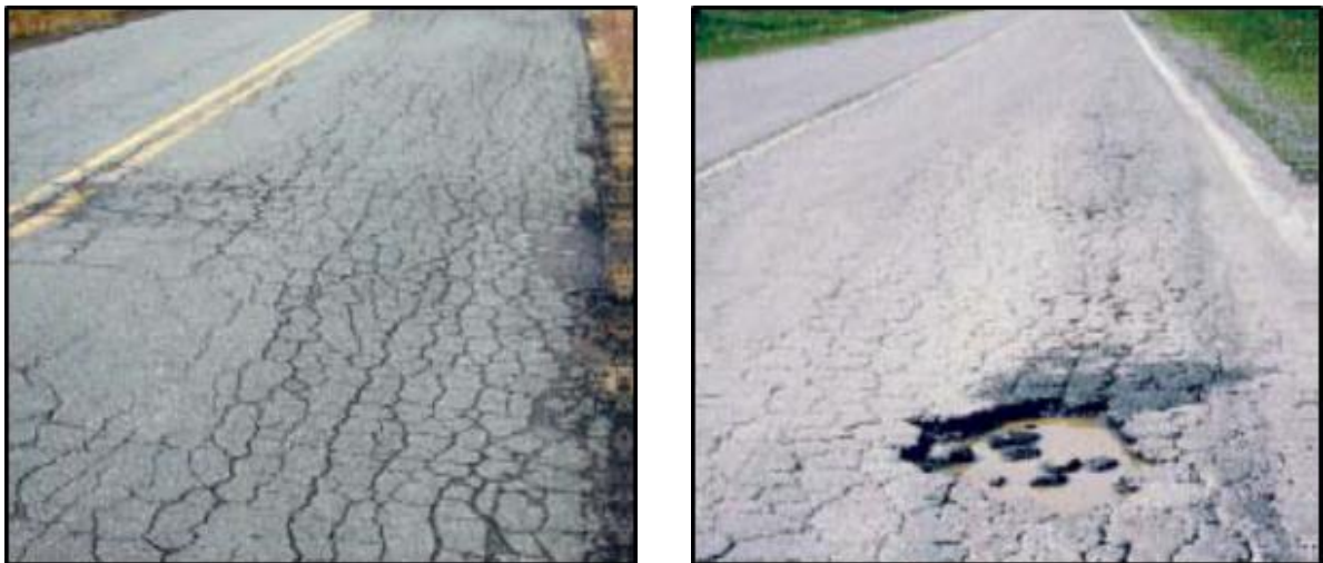
Figure 1. 1. Dégradation des chaussées souples.
