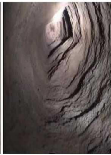
Puits de foggara vue de bas
