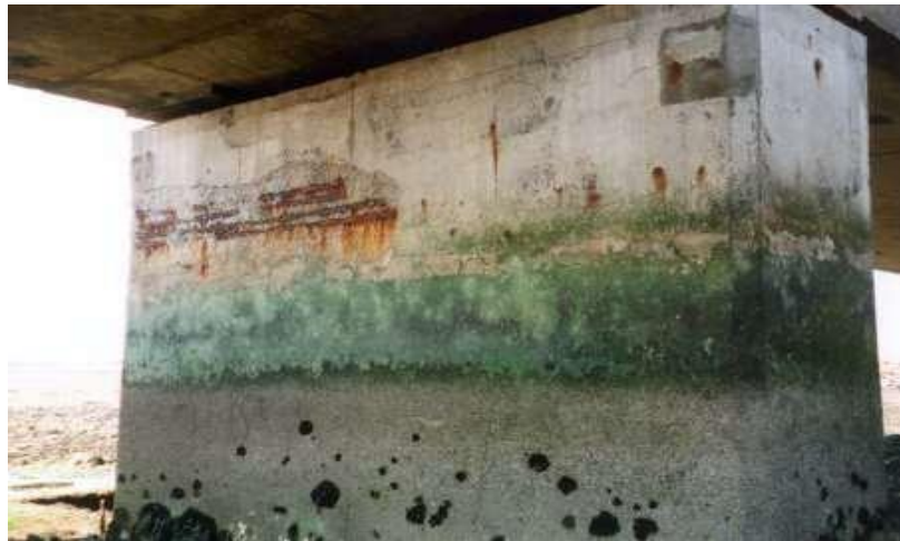
Figure I.5: Corrosion des armatures d'une pile de pont (AFCG, 2003)
