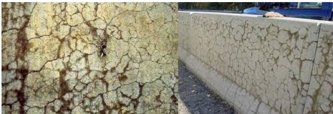
Figure I.6: Exemples de dégradations d'ouvrages dues à l'alkali-réaction[56]
