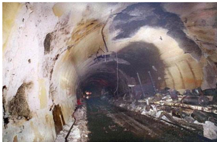
Figure I.1: Illustration d'un béton faïencé dans un tunnel suite à un incendie [36]
