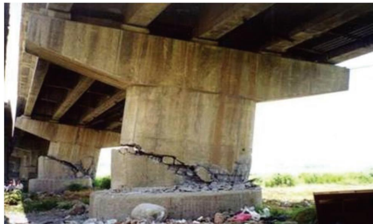
Figure I.3: Ruptures par cisaillement des piles [48]
