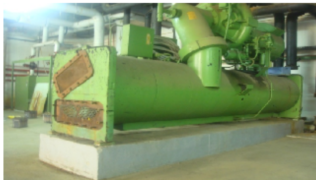
Figure 1. Vue d'ensemble machine-fondation
