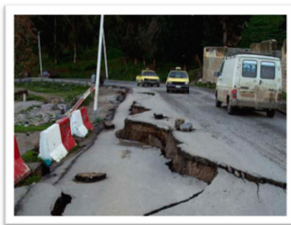
Photo 2. Affaissement et fissuration de la route du Bardo Source : Bougdal Rachid, 2007.
