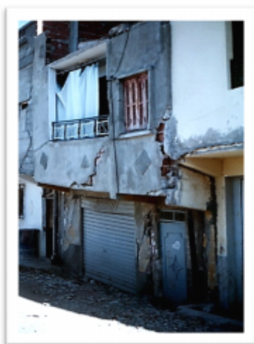
Photo 1. Une construction R+1 dégradée par le glissement, Située à Boudrâa Salah .Source : POS ; 2003
