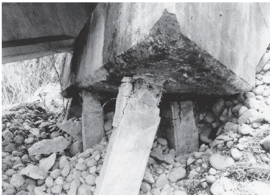
Figure 1.32 : Culée endommagée lors du séisme de 1991 au Costa Rica. [13]
