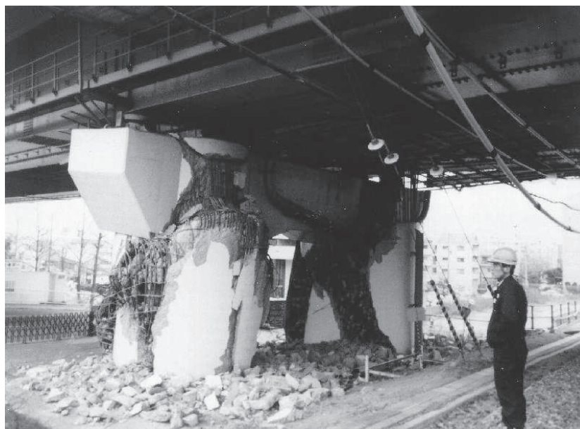
Figure 1.25 : Échec des deux fûts du pont lors du séisme de kobé à Hyogo-Ken Nanbu [1].
