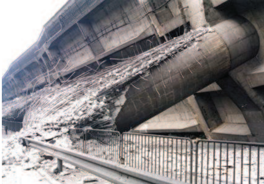
Figure 1.20 : Effondrement du viaduc de Hanshin, lors du séisme de Kobé à Hyogo-Ken Nanbu [12] - « Une défaillance prématurée en flexion des fûts en béton armé »
