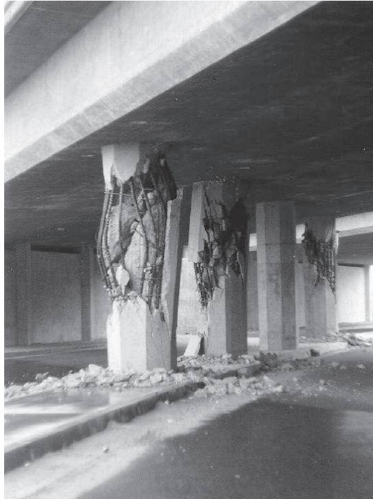
Figure 1.21 : Échec des fûts de la Route 5/210 de l'échangeur lors du séisme de San Fernando 1971 [1].
