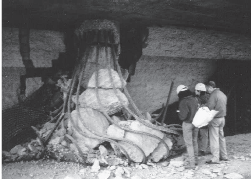
Figure 1.23: Échec des fûts de Cienaga-Venise lors du séisme de Northridge 1994 [1].
