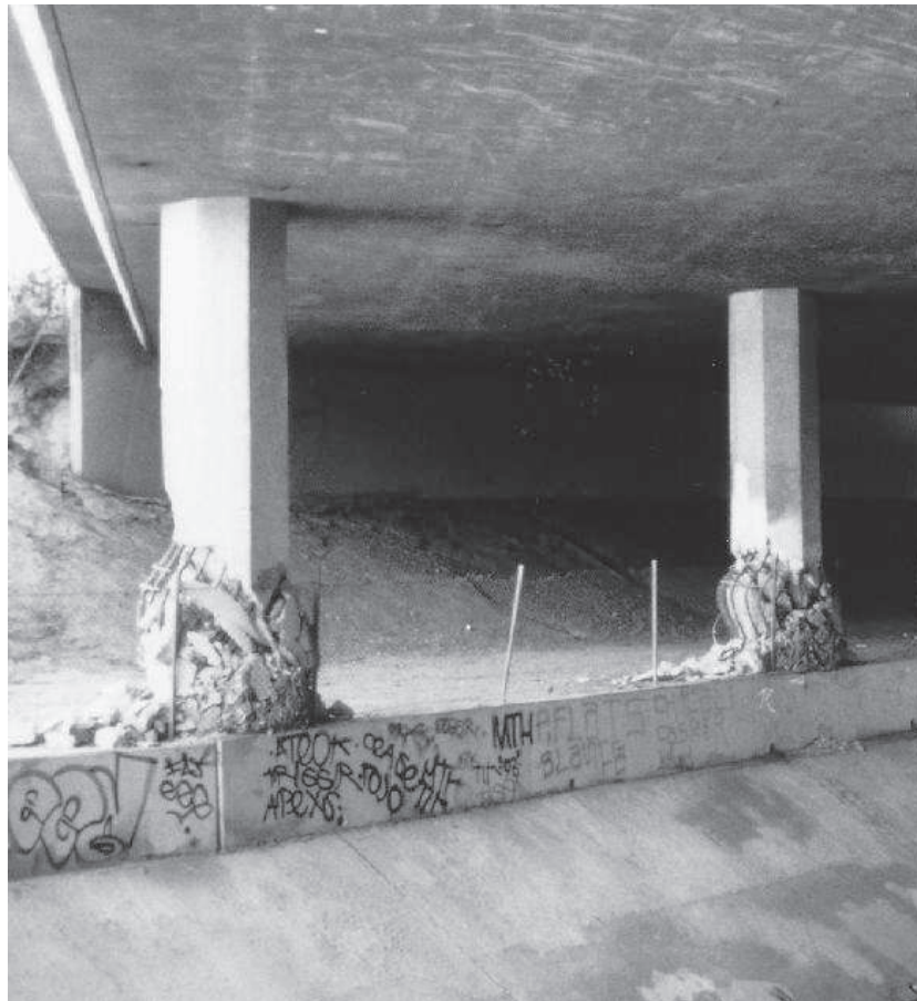
Figure 1.4 : Dommages du pont « Bull Creek Canyon » séisme de Northridge 1994 [11].
