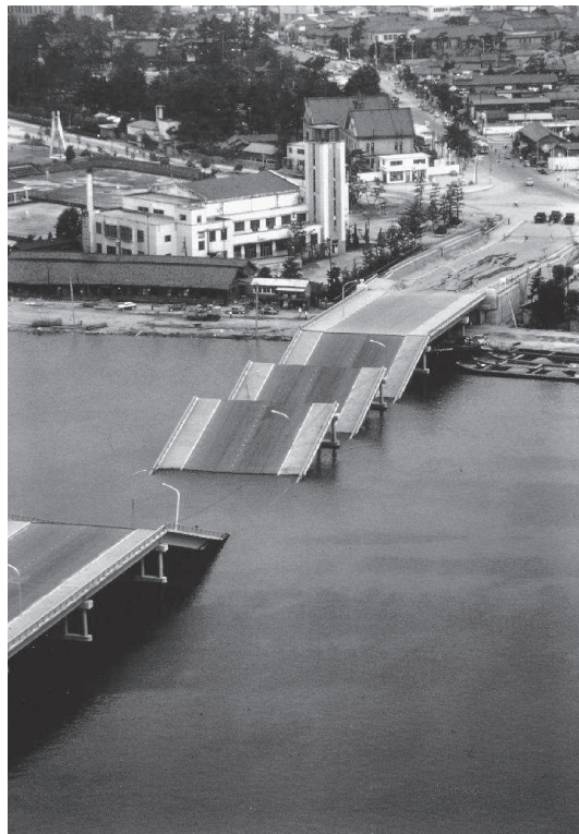
Figure 1.6 : l'effondrement du pont «Showa» durant le séisme de Niigata en 1964 [1].
