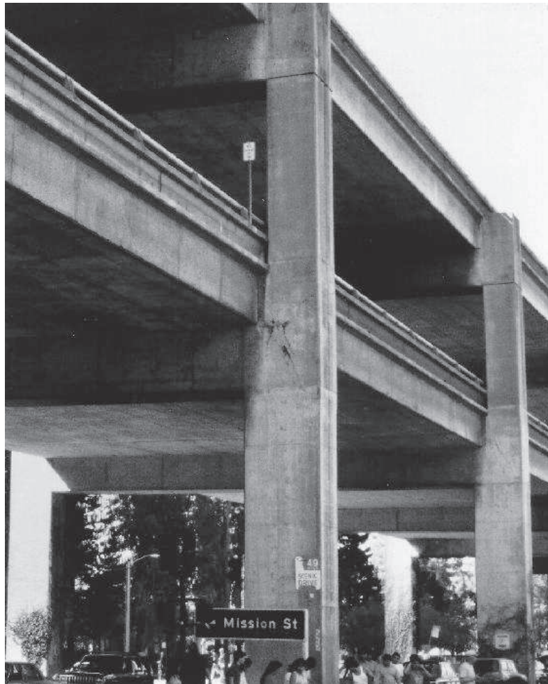
Figure 1.12 : Fissures de la jonction du Viaduc de Embarcadero à San Francisco durant le séisme de Loma Prieta en 1989 [1].
