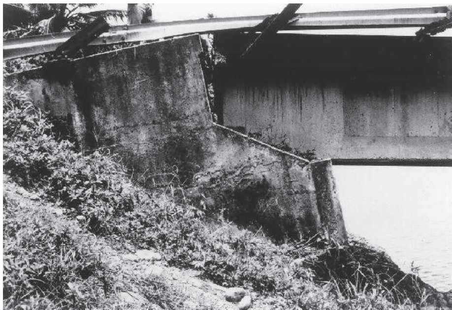
Figure 1.31 : Rotation de la culée due à la liquéfaction et à la propagation latérale lors du séisme de 1991 au Costa Rica. [13]
