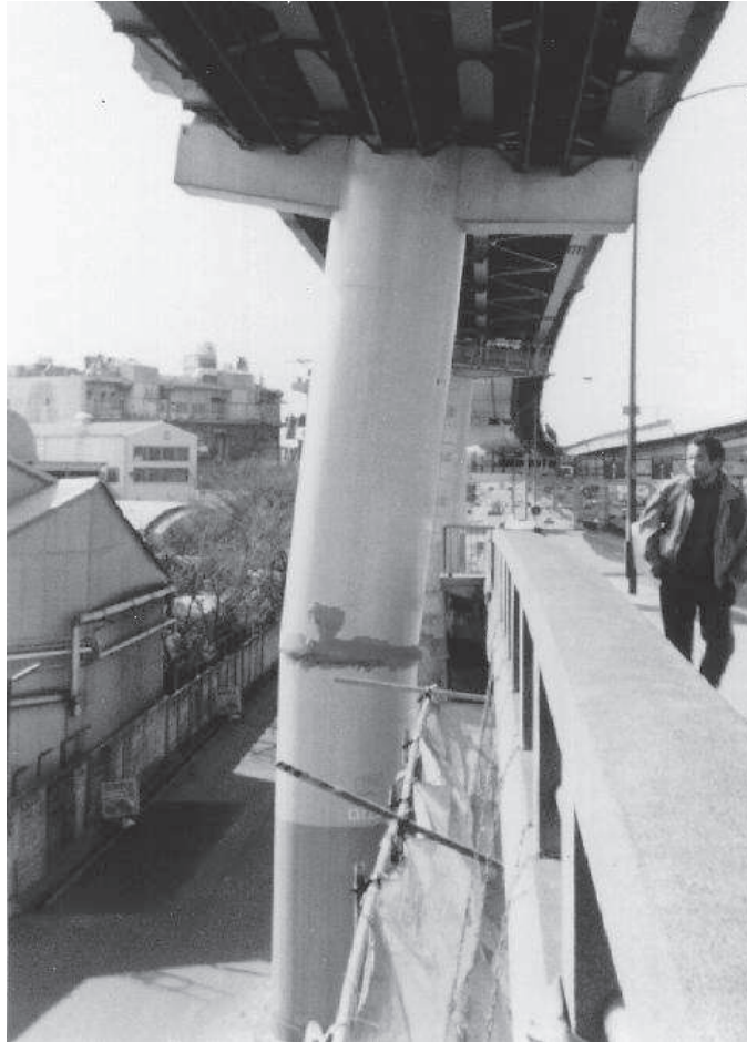
Figure 1.30: flambement local d'une section circulaire du fût du pont « Hanshin Expressway » lors du séisme de kobé en 1995 [18]
