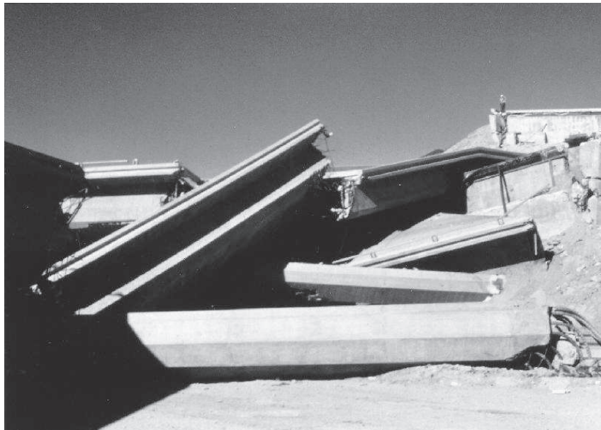
Figure 1.29 : la rupture d'un fût à sa base lors du séisme de San Fernando 1971 [14].
