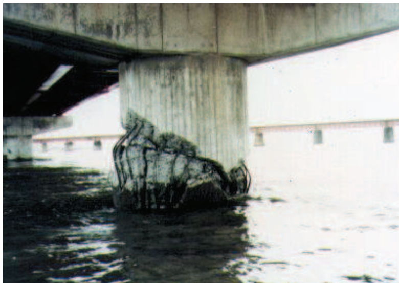
Figure 1.22 : Effondrement en cisaillement du fût en béton armé - Shizunai Bridge [12]
