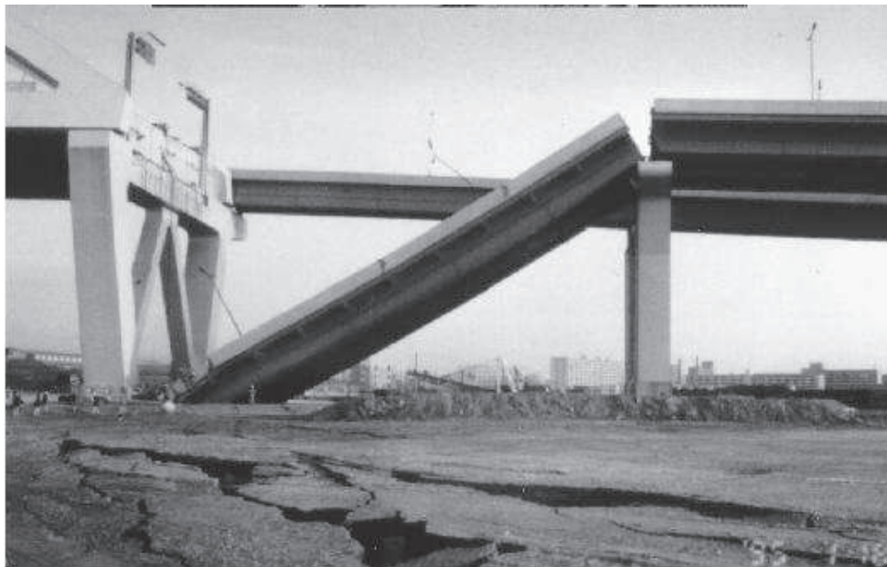
Figure 1.2 : Effondrement d'une travée du pont « Nishinomiya-ko » durant le séisme de Nanbu en 1995 [1].
