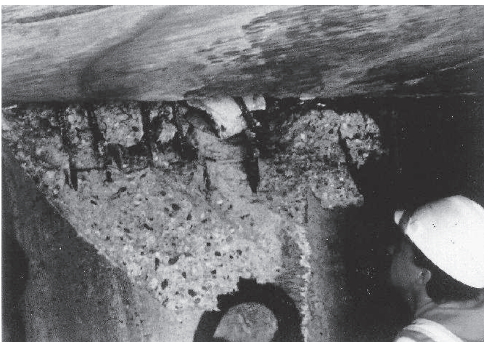
Figure 1.15 : Les dommages de la butée interne dans une culée lors du séisme de Northridge 1994[11].
