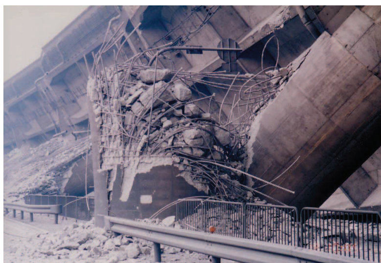
Figure 1.26 : Effondrement du viaduc de Hanshin, lors du séisme de kobé à Hyogo-Ken Nanbu [12] – « Une défaillance prématurée de cisaillement des fûts en béton armé »
