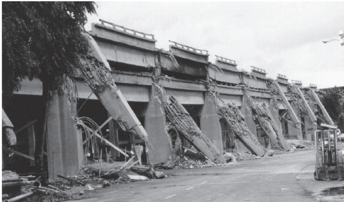
Figure 1.13 : Effondrement du Viaduc «Cypress Street» lors du séisme de Loma Prieta en 1989 [1].
