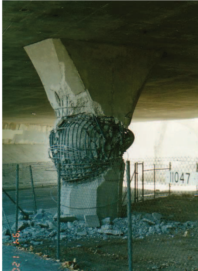
Figure 1.24 : Échec par cisaillement du fût du pont «Mission-gothique Undercrossing» lors du séisme de Northridge 1994 [12].
