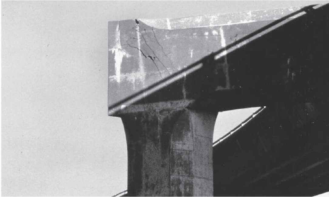
Figure 1.11 : les dommages possibles d'une partie d'une poutre durant le séisme de Loma Prieta en 1989 [1].
