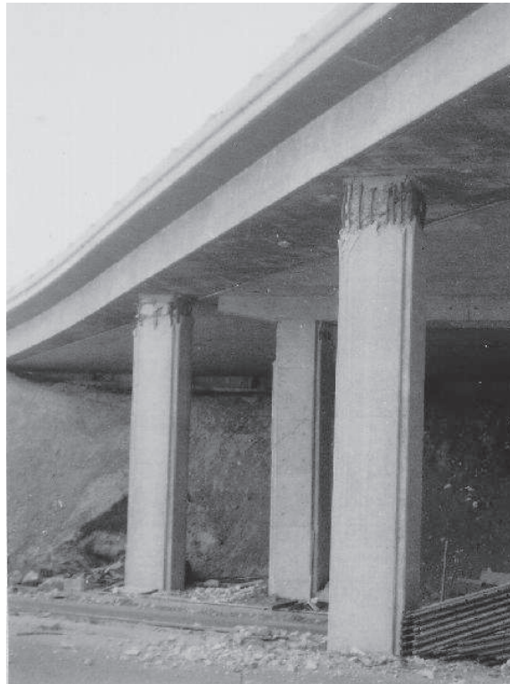
Figure 1.16 : Dommages à la tête du fût de la pile durant le séisme de San Fernando 1971 [15].
