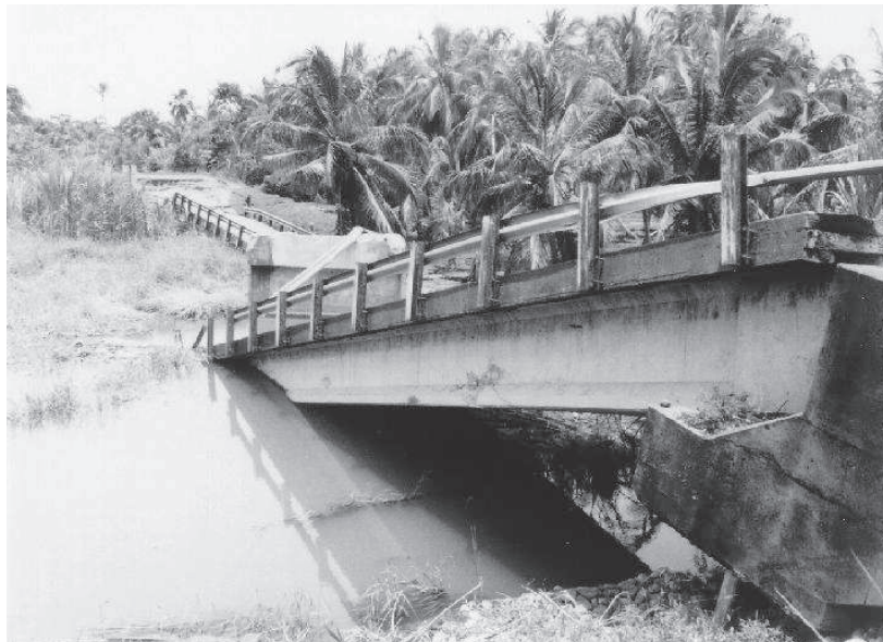
Figure 1.7 : Effondrement du Pont «Rio Bananito» durant le séisme de Costa Rica 1991 [13].
