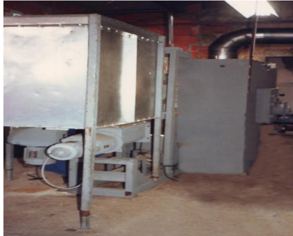
Photo (1) : Vue globale de la chaudière
