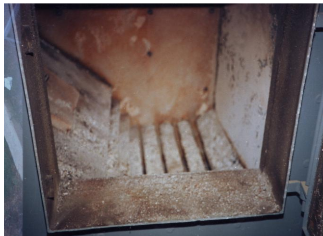
Photo (2) : Le foyer de la chaudière
