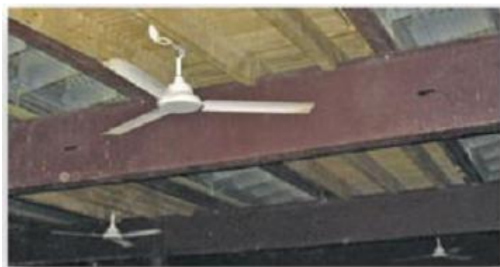
Fig 4-8 : Système de brassage d'air dans un bâtiment agricole d'élevage [62].
