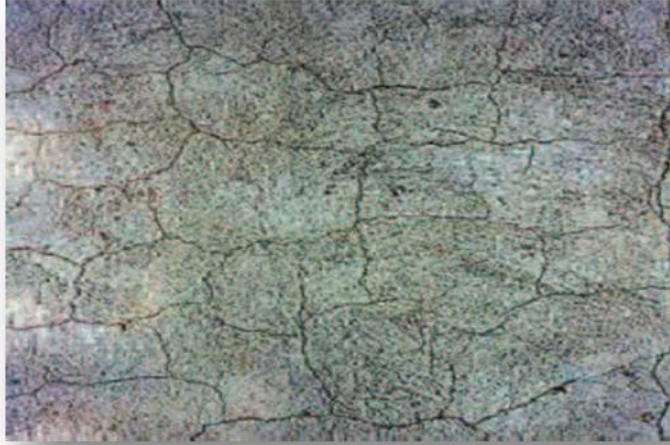
Figure 1.13 : Réseau de fissures de surface, imputables à l'absence ou l'insuffisance du traitement de cure [24].
