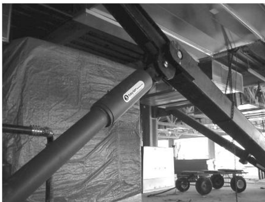
Figure 3.23 dispositif d'amortisseur visqueux installé en tant qu'élément diagonale d'une structure
