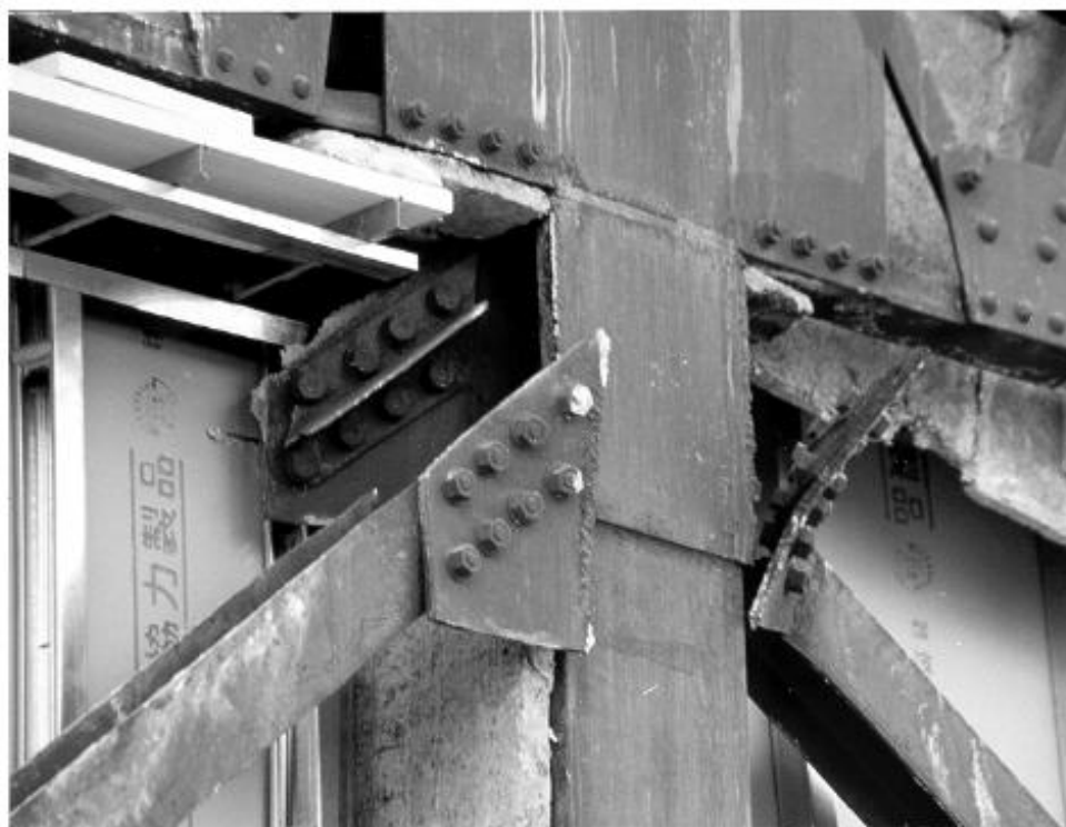
Figure 3.9 (a) Rupture fragile de la soudure des palées de contreventement
