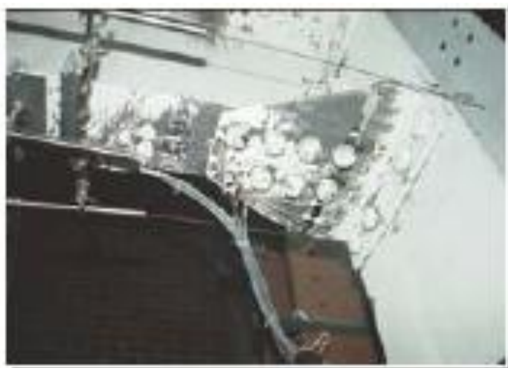
c). Rupture au niveau de la section nette de la plaque
