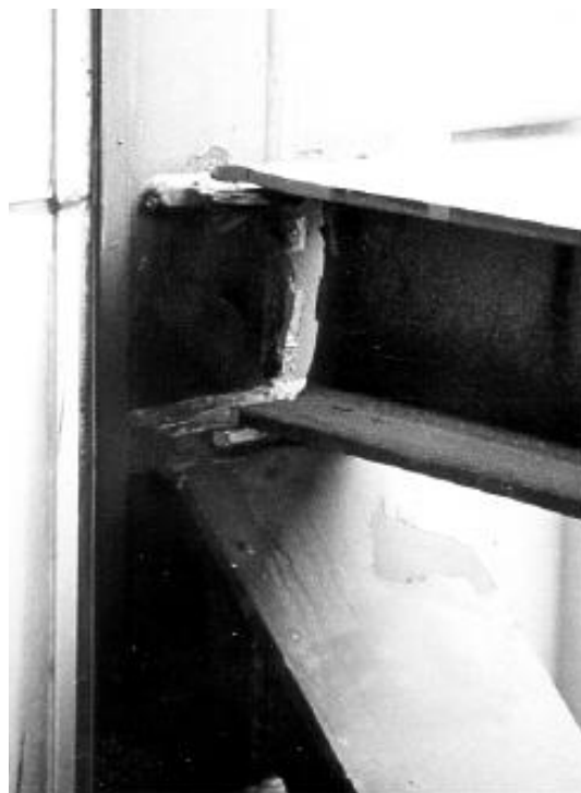
Figure 3.9 (b) Rupture fragile de la soudure des palées de contreventement
