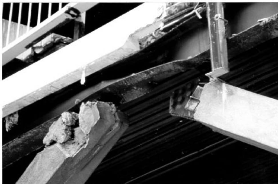
Figure 3.8 Voilement de la poutre sans appui latéral au niveau des palées de contreventement
