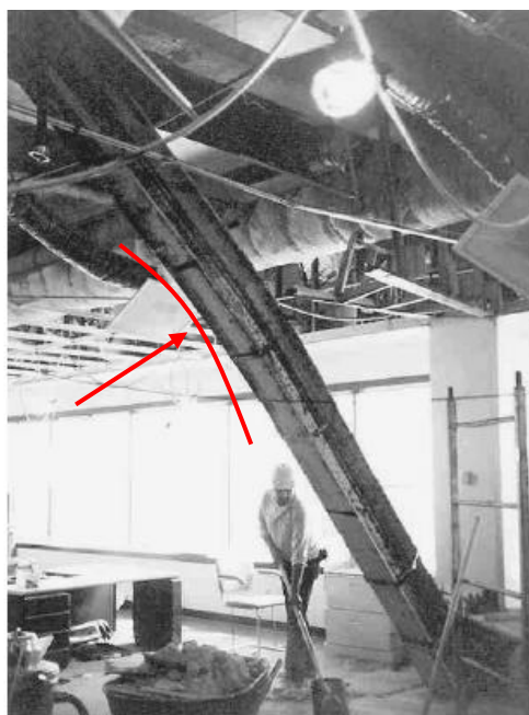
Figure 3.10 Flambement d'une diagonale d'un bâtiment en California
