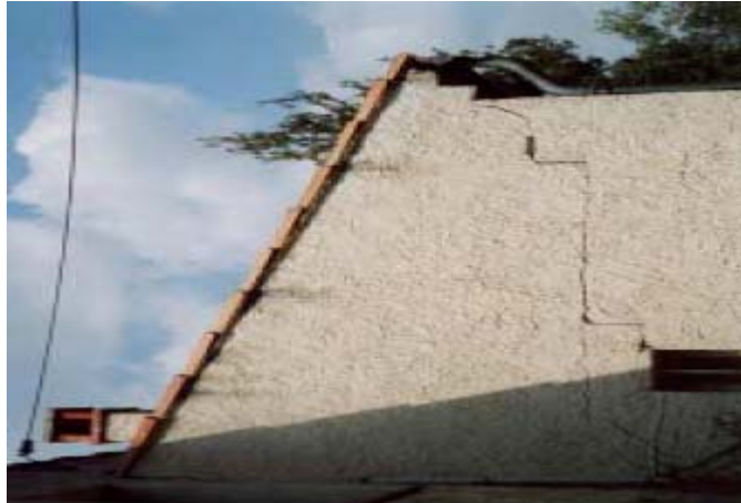
Photo N°1 : fissures au niveau d'une structure de génie civil
