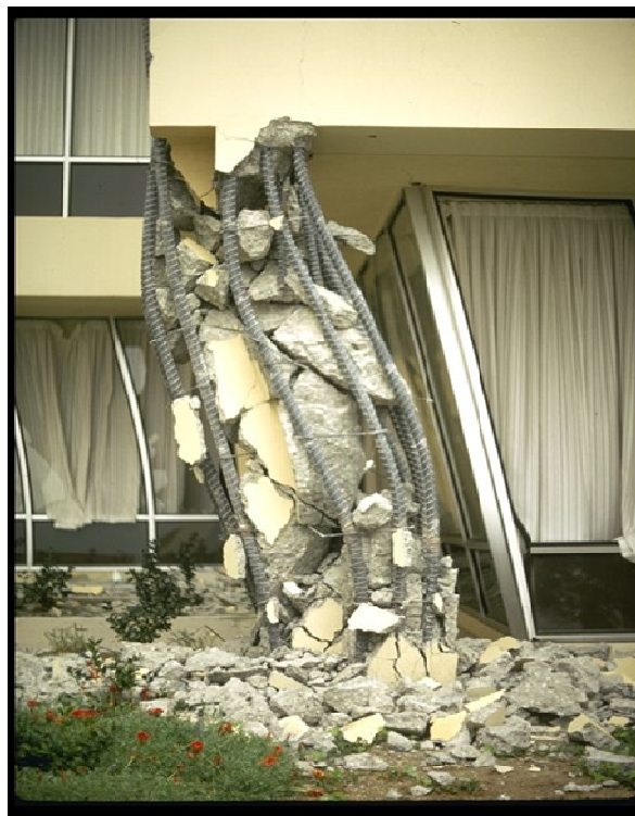
Figure 2.7 : Effondrement des poteaux d'un Hôpital par l'instabilité de forme (flambement)
