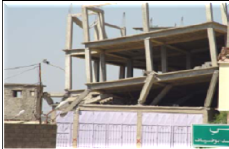
(a)- cisaillement des poteaux de l'étage intermédiaire
