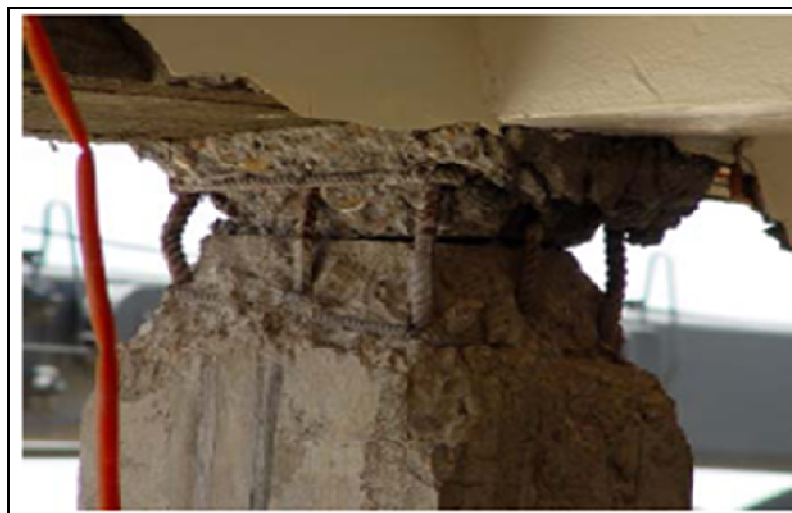
(b)- Destruction de l'extrémité du poteau
