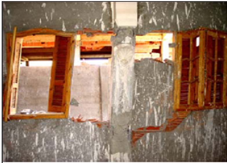
(a)- Poteaux courts en raison de la construction adjacente de maçonnerie
