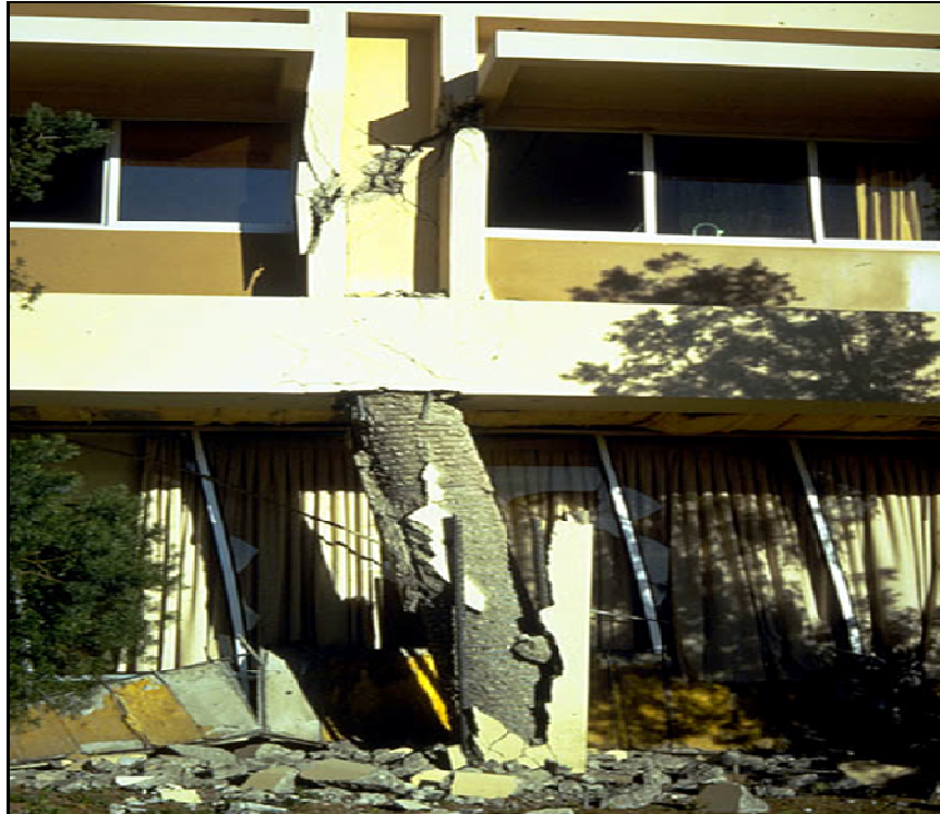
Figure 2.8 : Le poteau élancé du RDC est effondré par l'instabilité de forme, par contre, le poteau court du 1 er étage est effondré par cisaillement [16].
