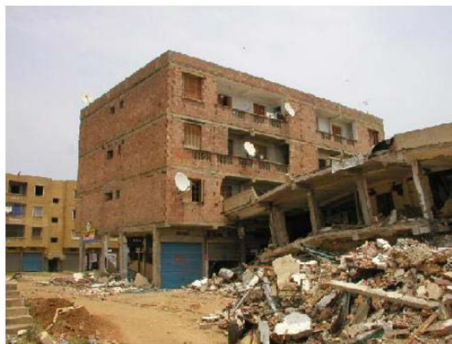
Fig. 1.9- Effondrement de type mille-feuilles d'un bâtiment R+3 à Boumerdes [11].
