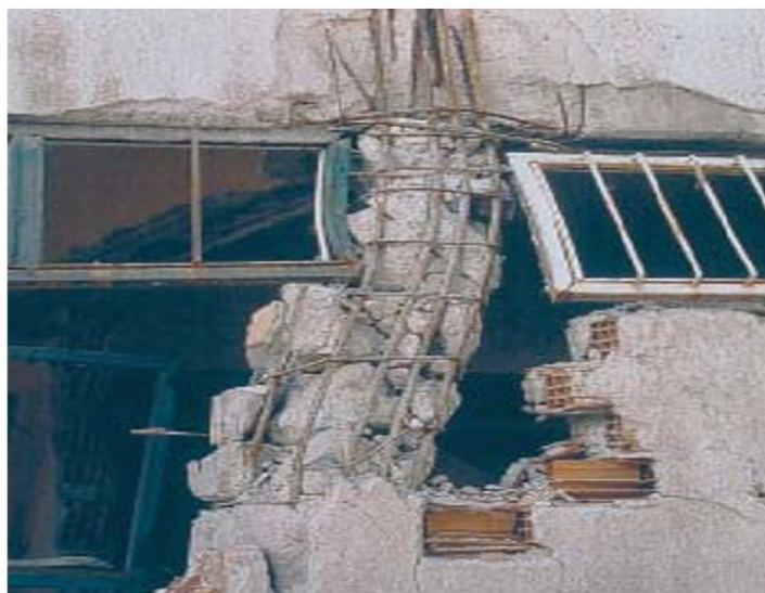
Figure 1.19: Défauts d'exécution dans le poteau (étriers avec crochets recourbés à 90^\circ au lieu de 135^\circ ), d'où rupture des ancrages [15].
