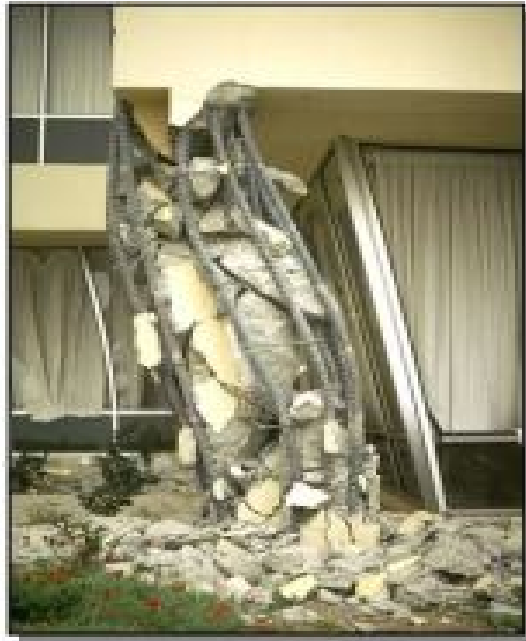
Figure 1.9 : Poteau avec les cadres insatisfaisantes [11].
