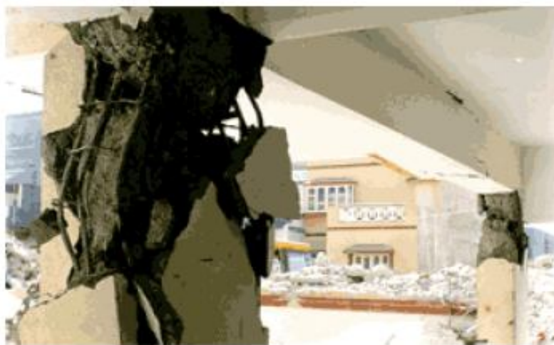
Figure 1.12 : Eclatement des armatures transversales sur la zone critique de poteaux. (Séisme de Bhuj, 2001) [12].
