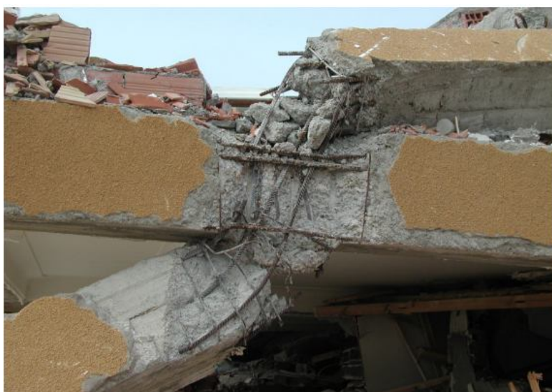
Figure 1.20 : Rupture en zone nodale [13].
