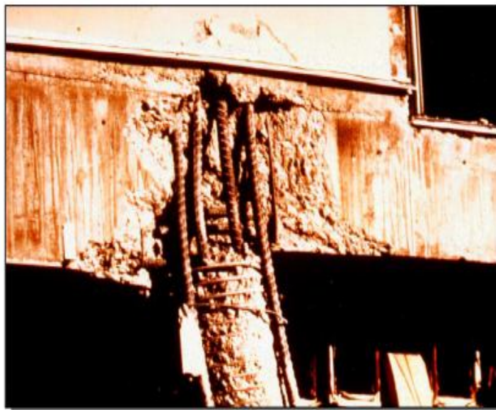
Figure 1.11 : Echec du nœud aucun armature de cisaillement (tremblement de terre 1971 de San Fernando) [11].
