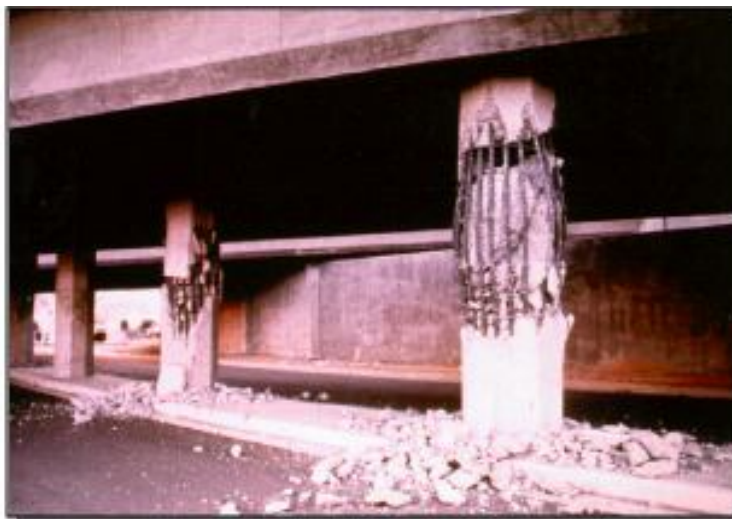
Figure 1.10 : Échec De Cisaillement De poteau (tremblement de terre 1971 de San Fernando) [11].
