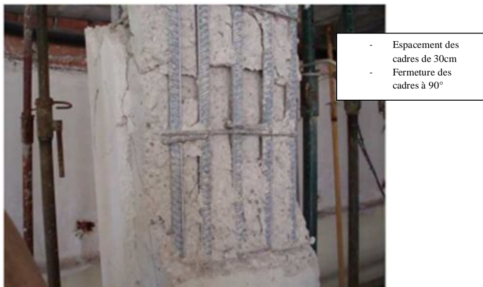
Figure 1.18 : Manque de dispositions constructives [9].
