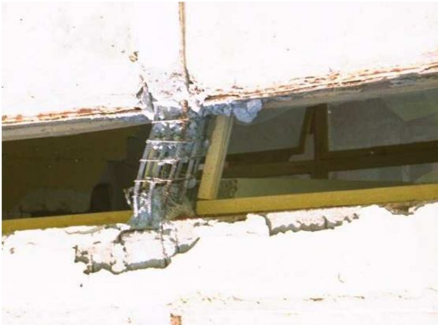
Figure 1.4 : Rupture d'un poteau court [8].
