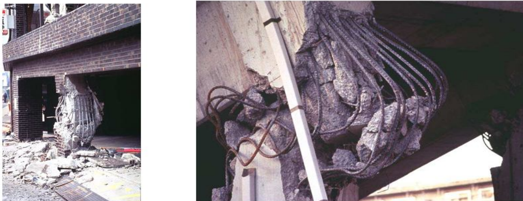
Figure 1.16: Effondrement de poteaux en béton armé du fait de manque de renforcement [14].
