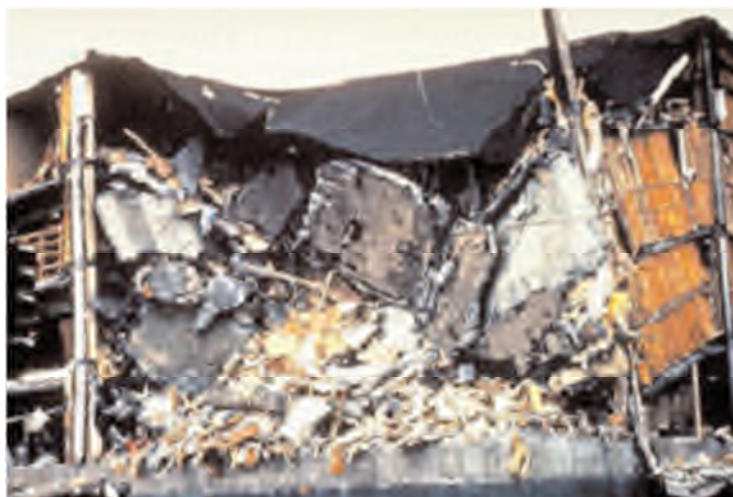
Figure.2.12: Effondrement d'un bâtiment par torsion en raison d'une disposition asymétrique des murs assurant le contreventement (séisme d'Anchorage, Alaska, 27 mars 1964)
