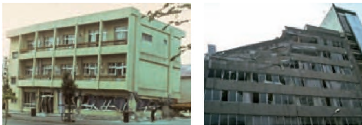
Figure.2.14 : Dommages sismiques dus à la torsion d'ensemble, séismes de Tokachi-Oki, Japon 1968 et du Mexique, 1985
