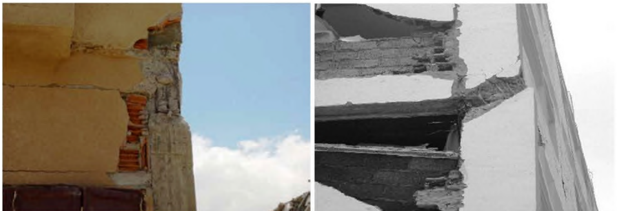
Figure I.6 : Eclatement de la zone nodale dû à la poussé diagonale de la maçonnerie.
