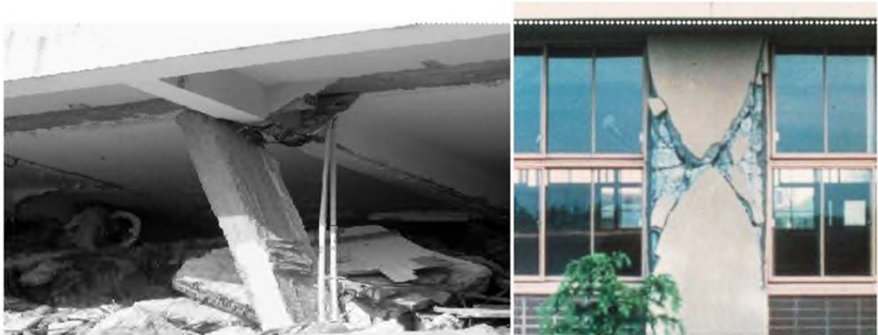
Figure I.4 : Cisaillement des Poteaux courts.
