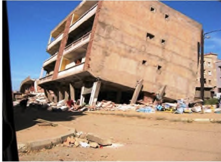
Figure I.7 : Effondrement de la structure sur le RDC.
