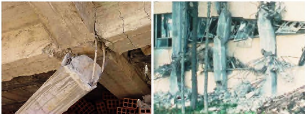
Figure I.3 : Plastification des poteaux avant les poutres.
