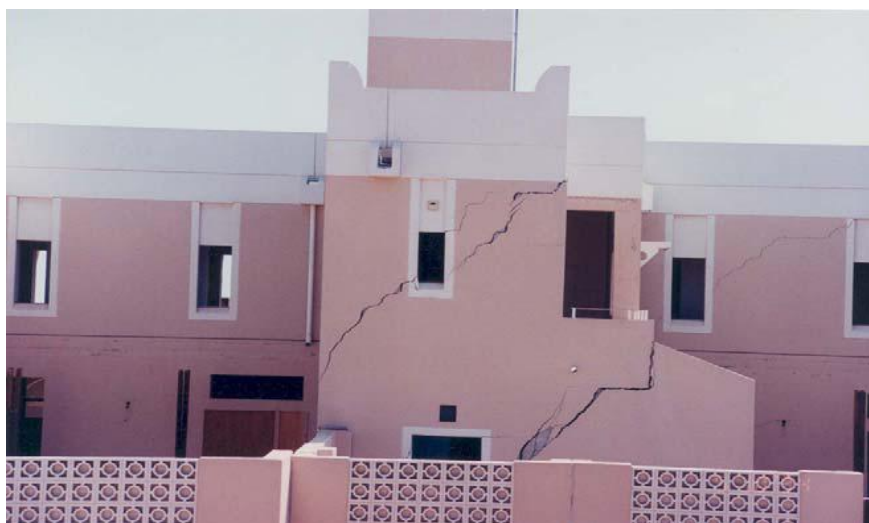
Fig. 1.5- Déformation structurelle due au gonflement du sol à Al-Khod(Oman) [Al rawas, 2005].
