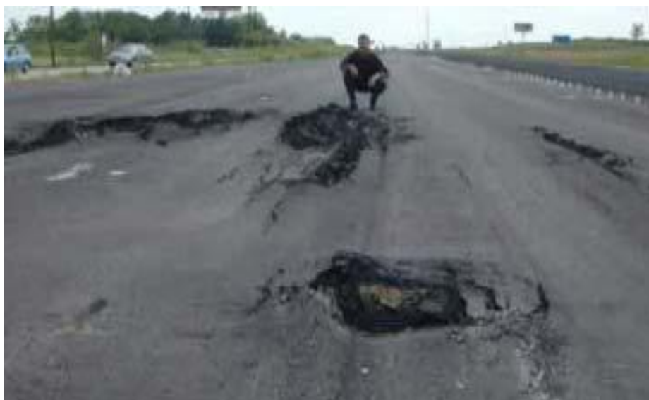
Fig. 1.6- Déformation d'une chaussée de sol instable. [Milburn et al.,(2004)].
