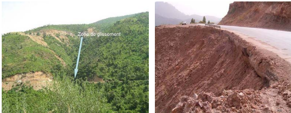
Figure 1. 22: Vue de la zone de glissement (Arab.R,et al 2009)
