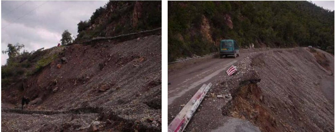
Figure 1. 19: Vue du glissement (Arab.R,et al 2009)
