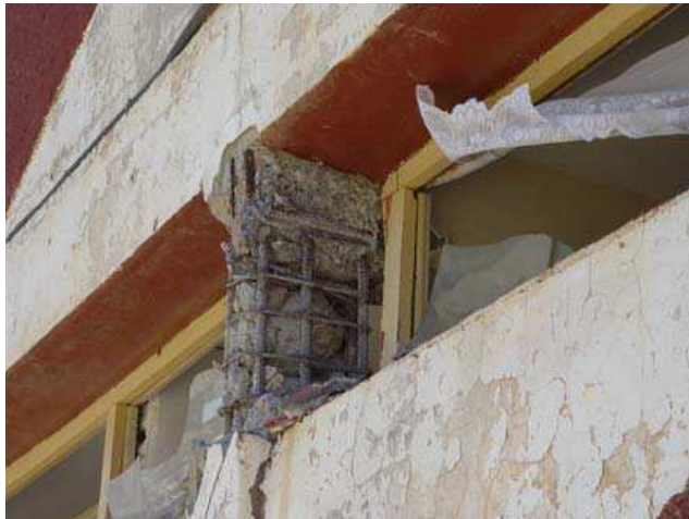
Photo 1.9: Destruction par cisaillement du poteau court Boumerdes (Algérie) en 2003 [12]
