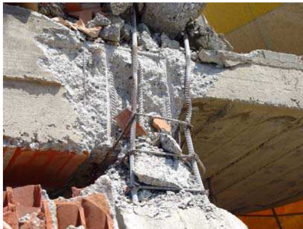
Photo 1.8: Absence d'armature transversale au nœud. Effondrement dû à cette absence au nœud et dans la zone critique du poteau, Boumerdes (Algérie) en 2003 [12].
