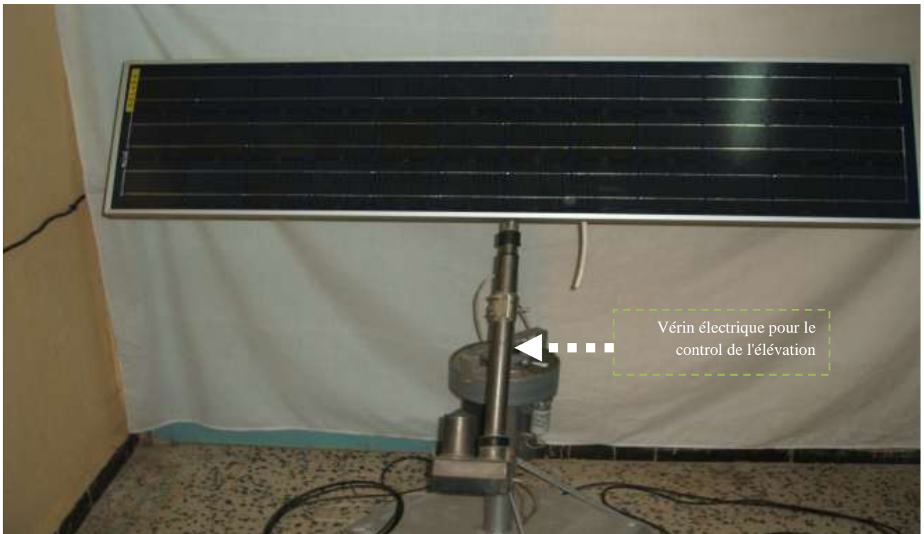
Figure (IV. 3) vérin de contrôle d'élévation
