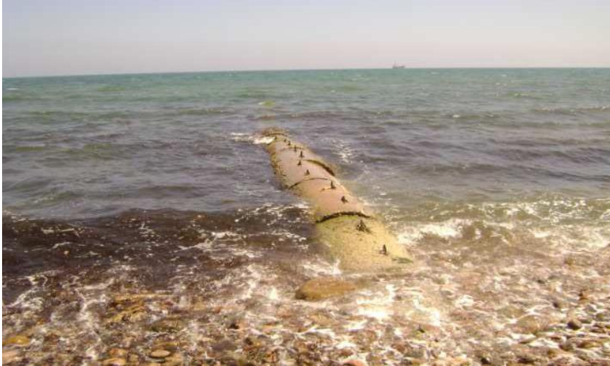
Figure IV.3 : Tuyau de captage de l'eau de mer.
