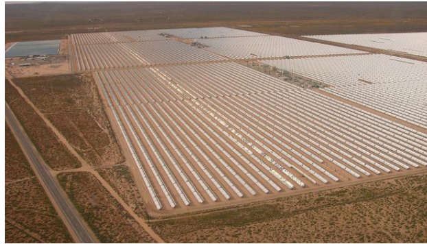
Figure II.3 : Centrales solaires à miroirs cylindro-paraboliques du sud-ouest des E.U.Amerique.
