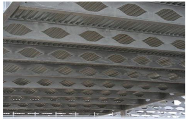
(d) Poutre Angelina [4].
