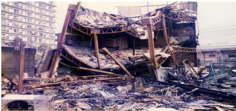
Figure 1. 3 Structure en acier endommagée par le feu[6].
