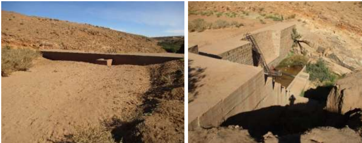
Fig.58 La situation actuelle du Barrage de Stitten ensablé à 100%
