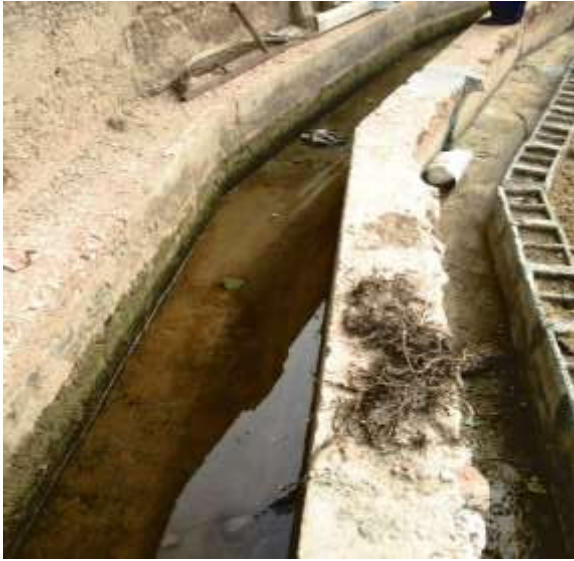
Fig.43 Une partie de la seguia Nakhara en bon état
