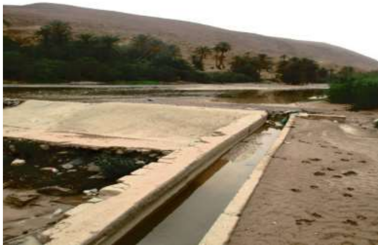
Fig.42 L'envasement occupe la majeure partie de la retenue du barrage Tahtani
