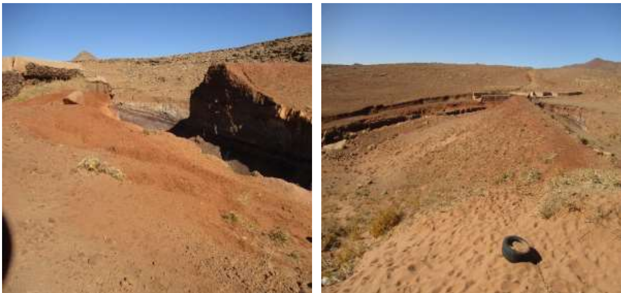
Fig.59 La situation de l'effondrement du barrage de Méchria Essghira après la crue
