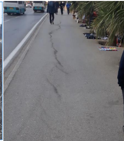
(b) Fissuration longitudinal
