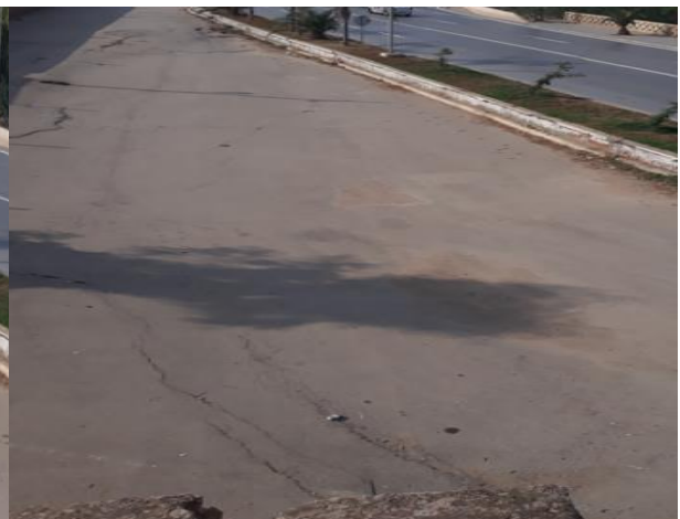
(g) tassement et fissuration longitudinal
