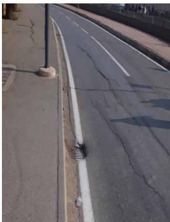
(c) Fissuration longitudinal
