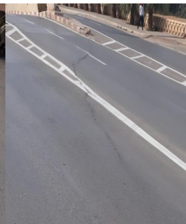
(e) Fissuration longitudinal
