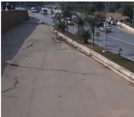
(f) tassement et fissuration longitudinal
