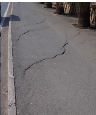
(d) tassement et fissuration
