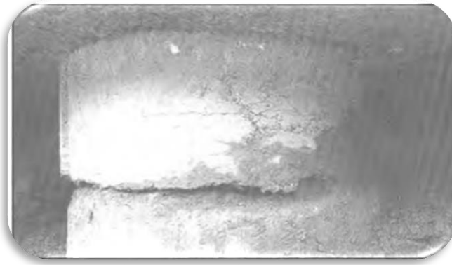
Figure I.17 : Dommages observés sur une tête de pieux. (Belmudes & Lestuzzi, 2006)
