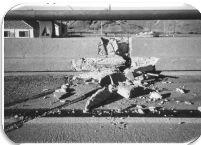
Figure I.18 : Dommages de la superstructure du pont de Santa Clara durant le séisme de Northridge en 1994. (Boutaraa, 2022)
