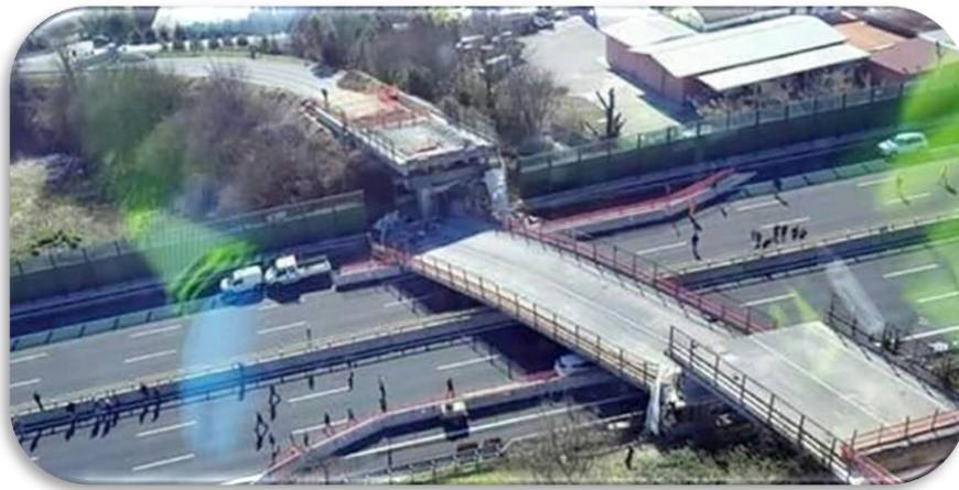
Figure I.11 : Chute de tablier d'un pont sous l'action sismique (Source : https://www.lepoint.fr )
