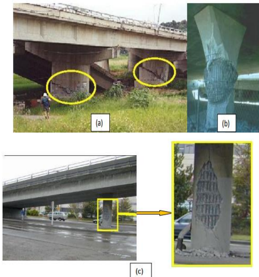
Figure I.15 : (a) Rupture des piles du pont par effort tranchant, (b) Flambement des armatures longitudinales + éclatement des armatures transversales de la pile, (c) Endommagement de la pile par flexion effort tranchant. (Setra, 2003)
