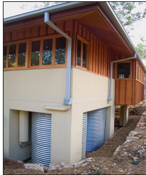
الصورة رقم 64: أنظمة تخزين مياه
