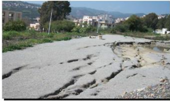
Fig. I.1 : Fissures, tassements sur la plateforme du stade à Bejaia (Belkaaloul et Araba 2020)
