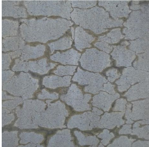
Figure 1.3: Fissuration due à la réaction alcali-silice dans le béton [24].
