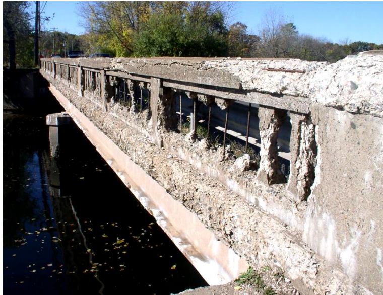
Figure 1.2: Détérioration avancée du béton armé due aux cycles de gel-dégel [19].
