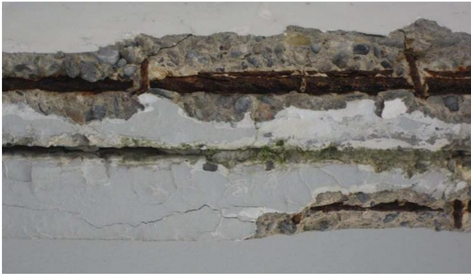
Figure 1.1: Dégradation du béton armé due à la corrosion des armatures [14].
