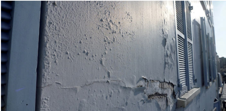
Figure I. 11: Endommagements des Revêtements [16].
