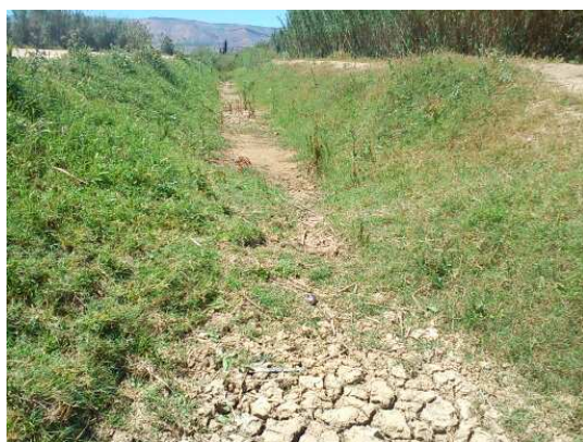
a. Drain mal entretenu (Ouarizane)
