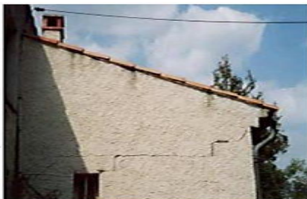
Figure. 1.6: Fissures au niveau d'une structure de génie civil
