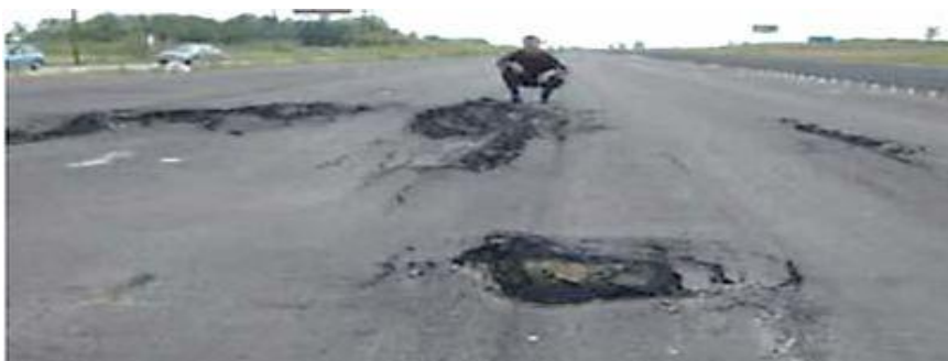
Figure. 1.7: Déformation d'une chaussée de sol instable
