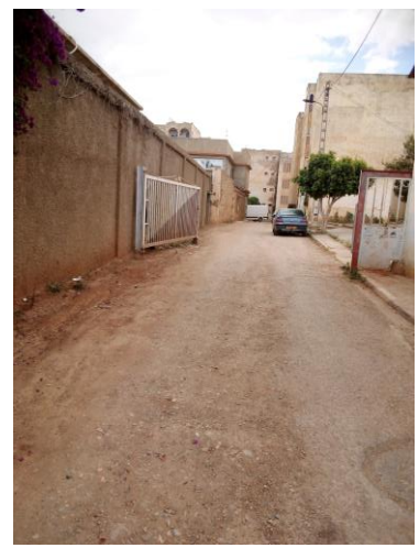
Figure 18: Voirie mauvais état
