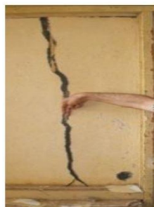
Fissure très importante de l'ordre de 02cm sur une cloison en maçonnerie
