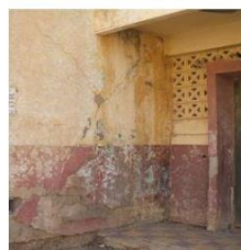
Fissures en croix à sur un pignon à l'entrée du bâtiment
