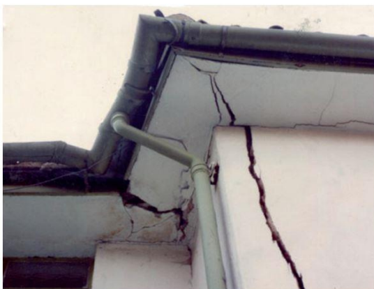
Figure I.8. Dommages structurels à une maison causés par un 'soulèvement des extrémités' (Jones, 2017)
