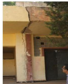
Ouverture du joint
