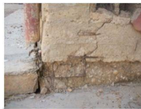
Cisaillement d'une longrine avec Effritement du béton
